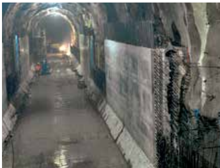
Det bedste støberesultat fra den 2.takt (vægareal) danner udgangen for den buede forskallingsvogn.
