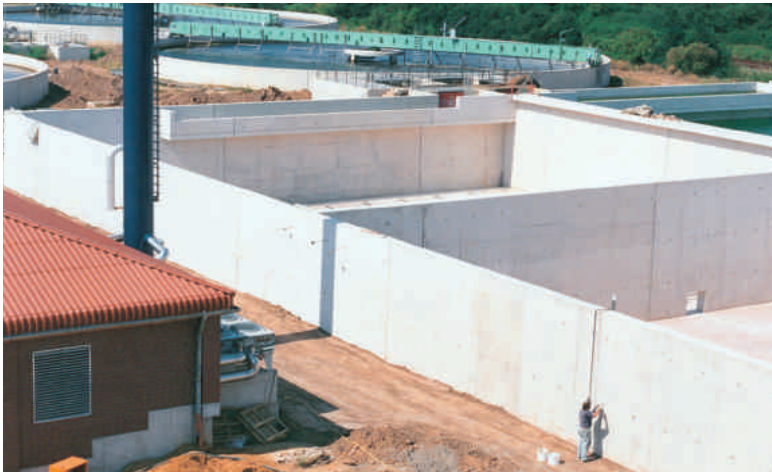
Rensningsanlæg i Hameln, Tyskland.
