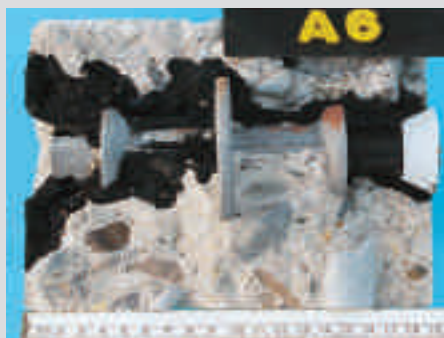
Dannelsen af svindrevner gør at ankerstavene...
