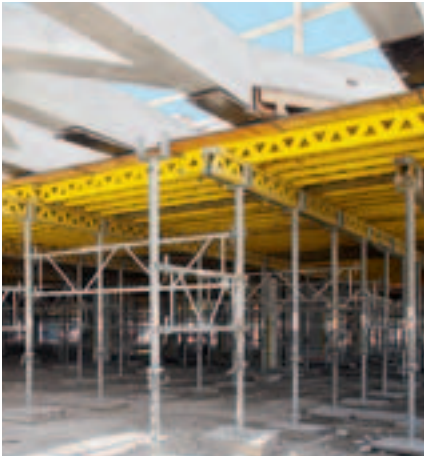
MULTIFLEX dækforskalling – udført med GT 24 forskallingsdrager – bærer her et gitter af bjælker i synlig beton, der senere skal bære et elementdæk.
