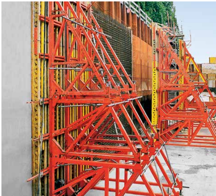
Maks. støbehøjde på 8,75 m, støttebuk-AO, A, B, og C med vægforskalling VARIO GT 24.
