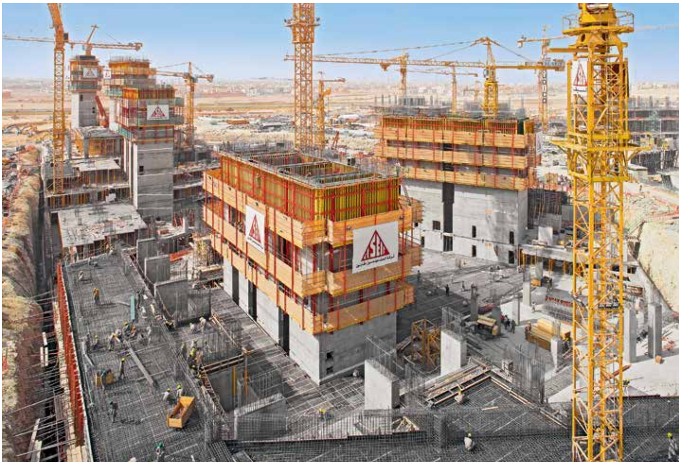
VARIO GT 24 på RCS Skinneklatringssystem til opførelse af elevator- og trappeskakt på et højhus.
