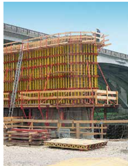
Bropiller på flodbredden forskallet med VARIO GT 24 på PERI klatrekonsol KG 240. De spidse og buede ender blev forskallet med VARIO standarddele og forskallingsbrætter.
